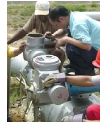
现场服务 Site Service
