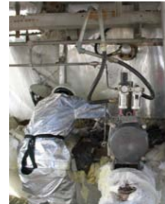
现场服务 Site Service
